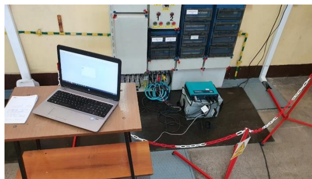
Rys. 3. Podłączenie analizatora Memobox 800 – obwody potrzeb własnych podstacji trakcyjnej – Punkt D
