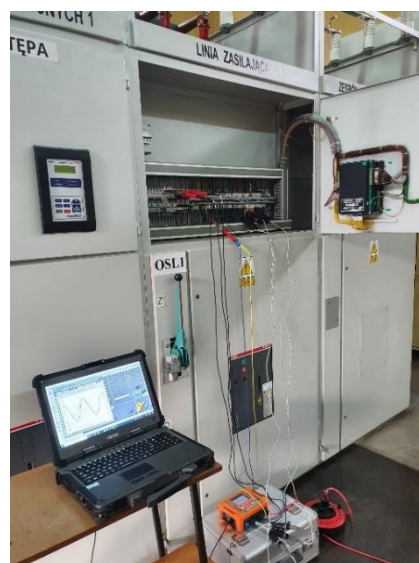
Rys. 2. Podłączenie analizatora PQM – 711 – linia zasilająca podstację trakcyjną – Punkt A
